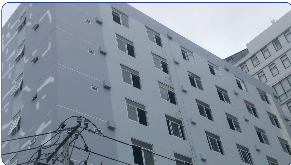
Nứt da quy bờ tường lan can cao nhất tòa nhà
