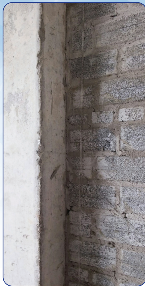
Nứt tại nơi tiếp giáp với cột bê tông
