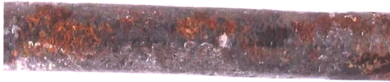
cốt thép 1 (vùng bê tông ẩm)
